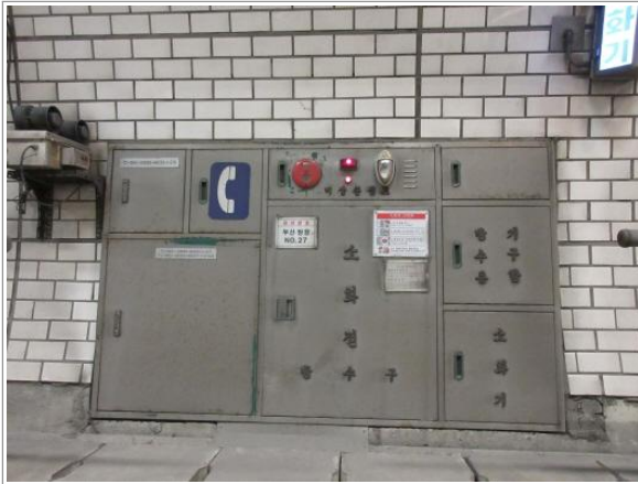
소화기 및 비상전화, 비상콘센트 전경
