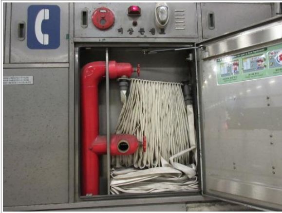
소화시설 및 비상전화, 비상콘센트 전경
